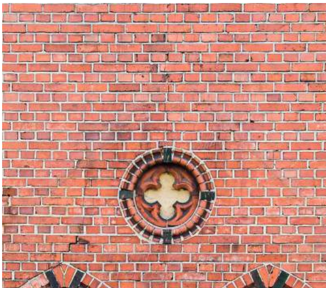
Zdjęcie nr 3. Uszkodzenia będące wynikiem wstrząsów górniczych.
